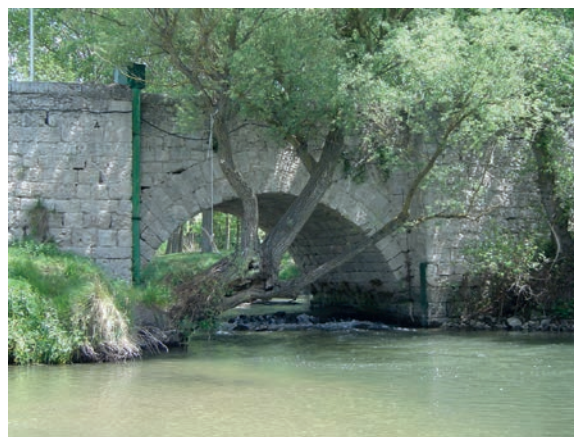
Fig. 6. Arco 2.º, aguas abajo, de Agustín de Zorlado, 1670-1676. Véanse las dovelas de doble rosca (fotografía del autor, 2005).
