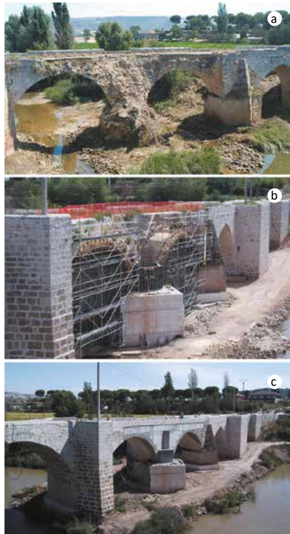
Fig. 12. a) Ruina de los arcos 4.º y 5.º, con su pilar, aguas abajo, 2005. b) Proceso de reparación de los arcos 4.º y 5.º, aguas abajo, 2006 (fotografía de Carlos Infante). c) Proceso de reparación de los arcos 4.º y 5.º, aguas abajo, 2006 (fotografía de Carlos Infante).
