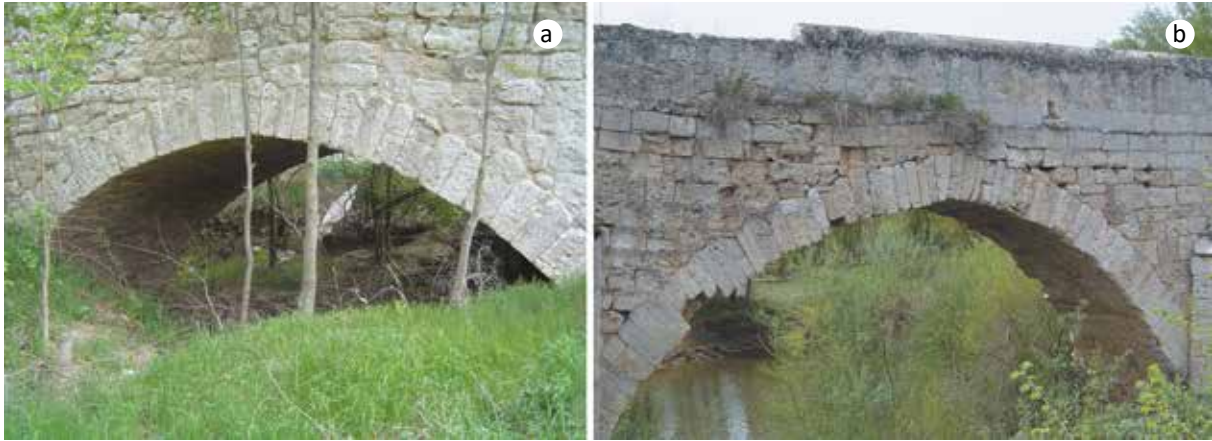
Fig. 3. a) Arco 1.º, románico. Antes de la restauración de 2004 (fotografía del autor). b) Arco 4.º, románico. Antes de la restauración de 2004 (fotografía del autor).
