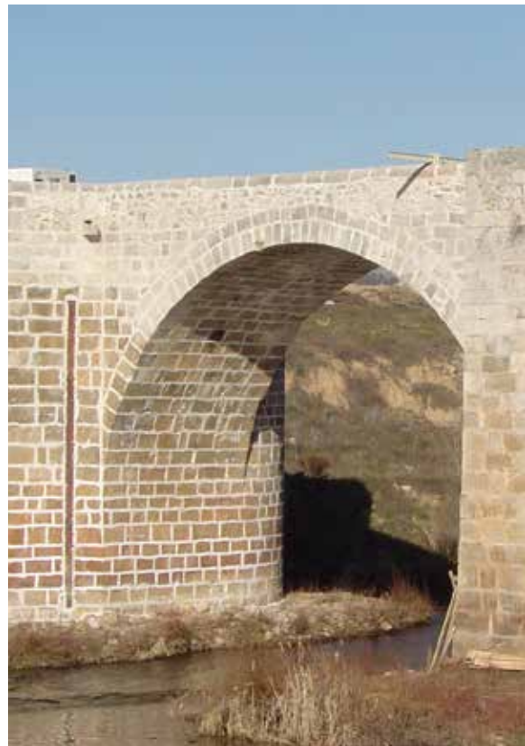
Fig. 7. Arco 7.º, renacentista, aguas abajo, 2006. Se puede apreciar la armonía de toda la estructura y una regla para marcar el nivel del agua (fotografía de Carlos Infante).
